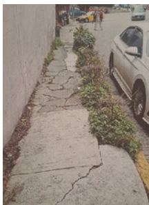
(Ejemplo de fotos tomadas para solicitud de permisos de reparaciones)
